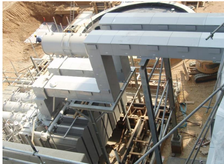
Rys. 2. Fragment instalacji szyno-toru.
